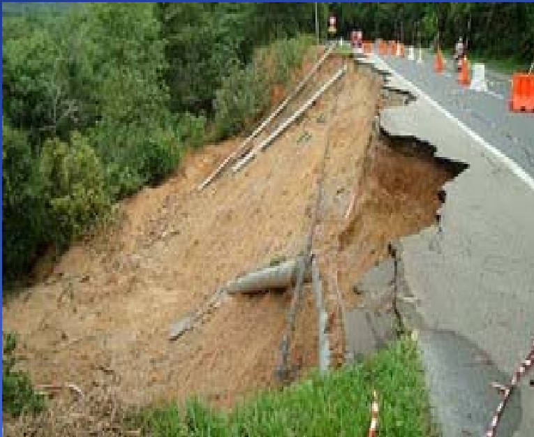
Kasus longsohnya struktur dinding penahan tanah
