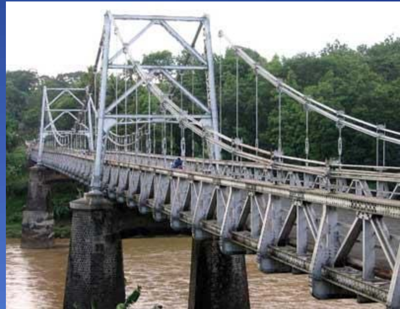
Struktur bawah jembatan ini sangat rawan terhadap terkikisnya pilar penyangga oleh Aliran air sungai
