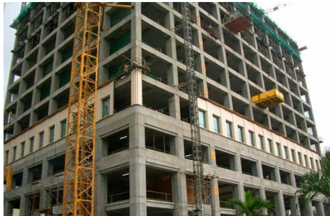
Gambar 33. Aplikasi jepit sempurna pada bangunan gedung berlantai banyak
