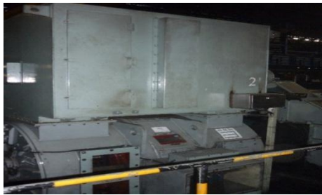
Gambar 4: Foto Mesin DC 3 2000KW
