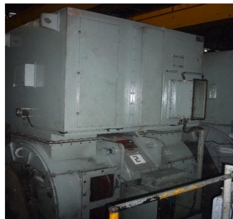
Gambar 3: Foto Mesin DC 2 2000KW
