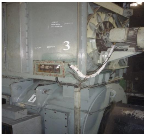
Gambar 2: Foto Mesin DC 1 2000KW
